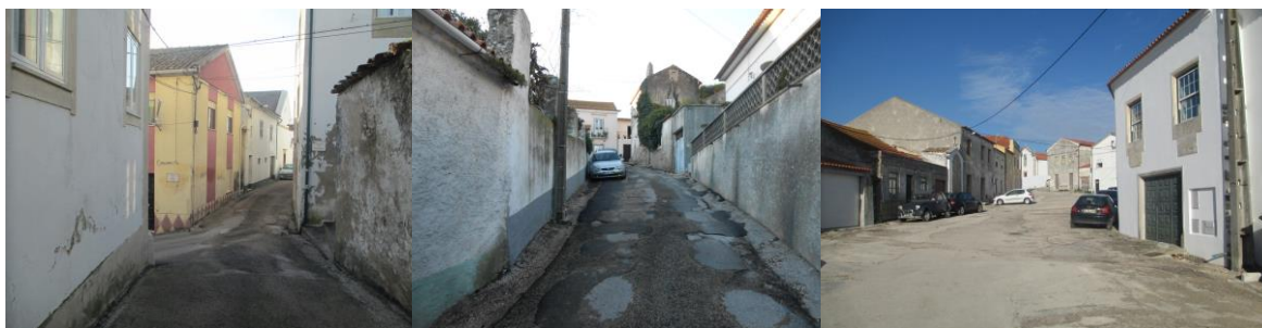
Figura 46. Exemplos de rede viária em mau estado de conservação na ARU da Vila de Montemor-o-Velho
